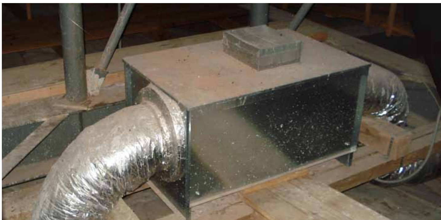
Центральный вентилятор, расположенный над трапезной храма.
